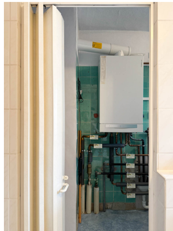
OG Bad Technikraum
